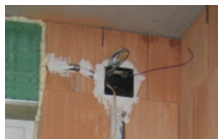
Abbildung 8-3: Praxis-Projekt herkömmliche Elektroinstallation
